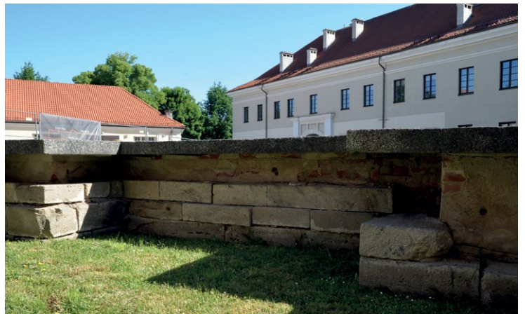
5. Fragm. zachowanego cokołu kościoła pw. św. Anny i św. Barbary od strony południowej, przykryty zabezpieczającą betonową płytą. Fot. K. Guttmejer, 2023 r.
