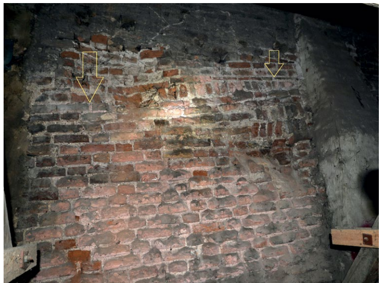
19. Różnica muru na poddaszu budynku.
